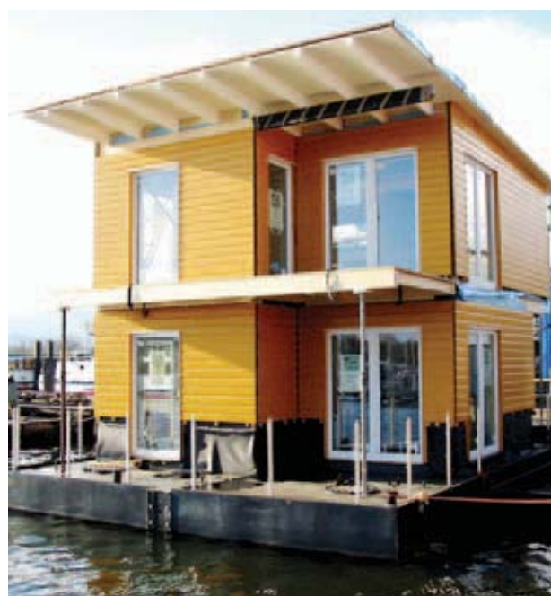
Bild 2 Die Häuser werden wie normale Einfamilienhäuser konstruiert. Die übliche Bodenplatte ist durch ein 7 m x 9 m großen Ponton ersetzt und der Spritzwasserschutz wurde verstärkt. Bis zu einem halben Meter Wellenschlag halten sie aus.
